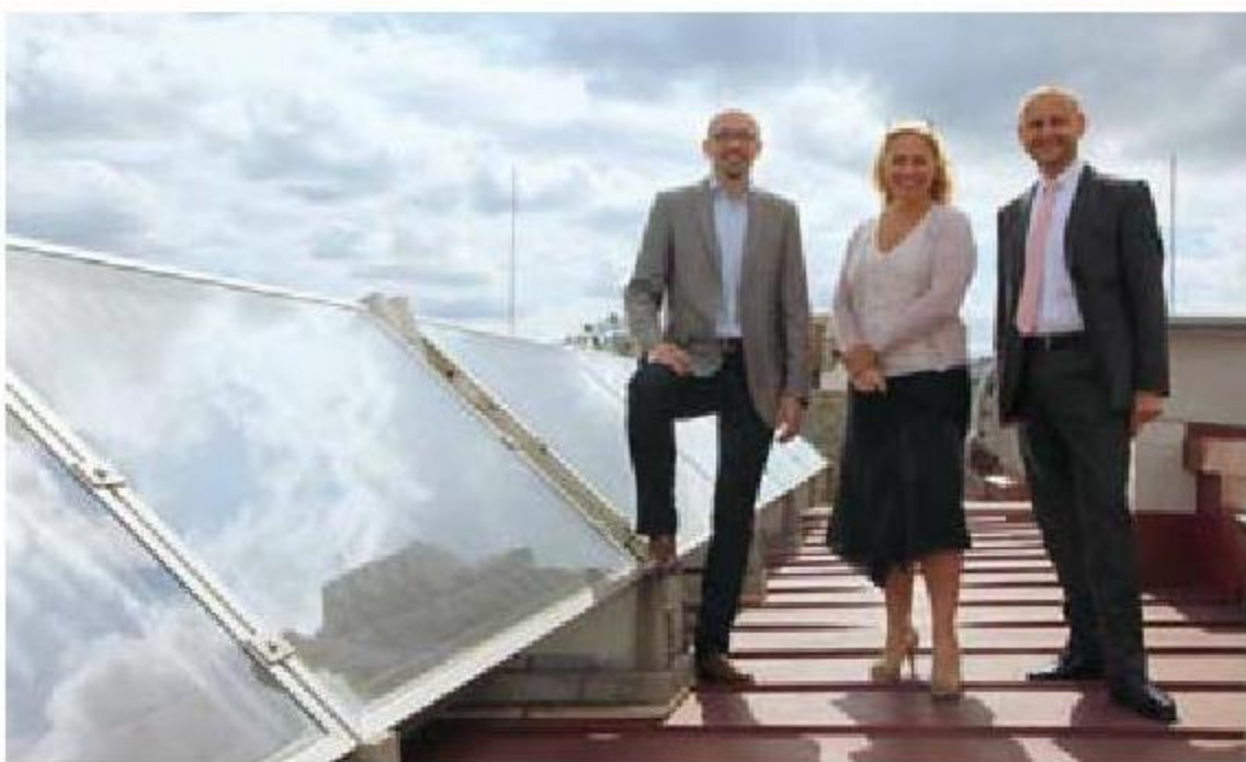
Beim Wilhelmshof wurde die Nachhaltigkeit mit einer Solaranlage auch gleich als „Dach-Marke“ installiert
